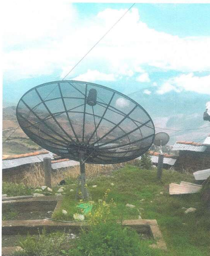
Ilustración 1. Antena Parabólica cuyos pétalos se encuentran en buen estado, se necesita mantenimiento de cablería y accesorios.
