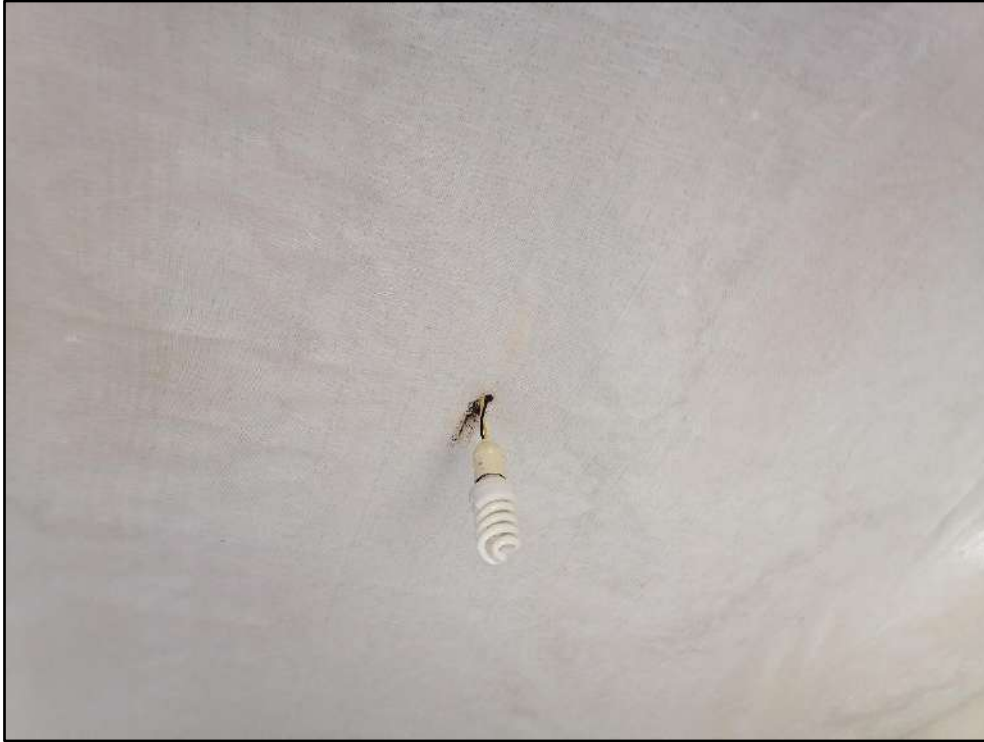
Imagen 11. Foco de caseta sin socket y cable expuesto. Techo de caseta cubierto con saco.
