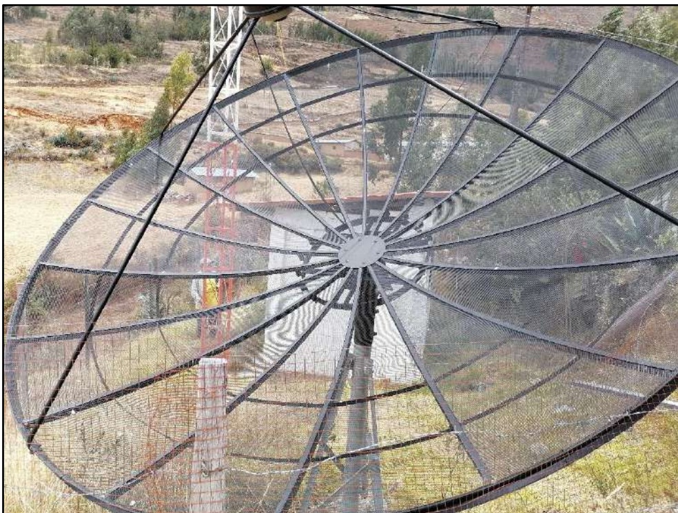
Imagen 2. Antena Parabólica cuenta con 2 pétalos averiados.
