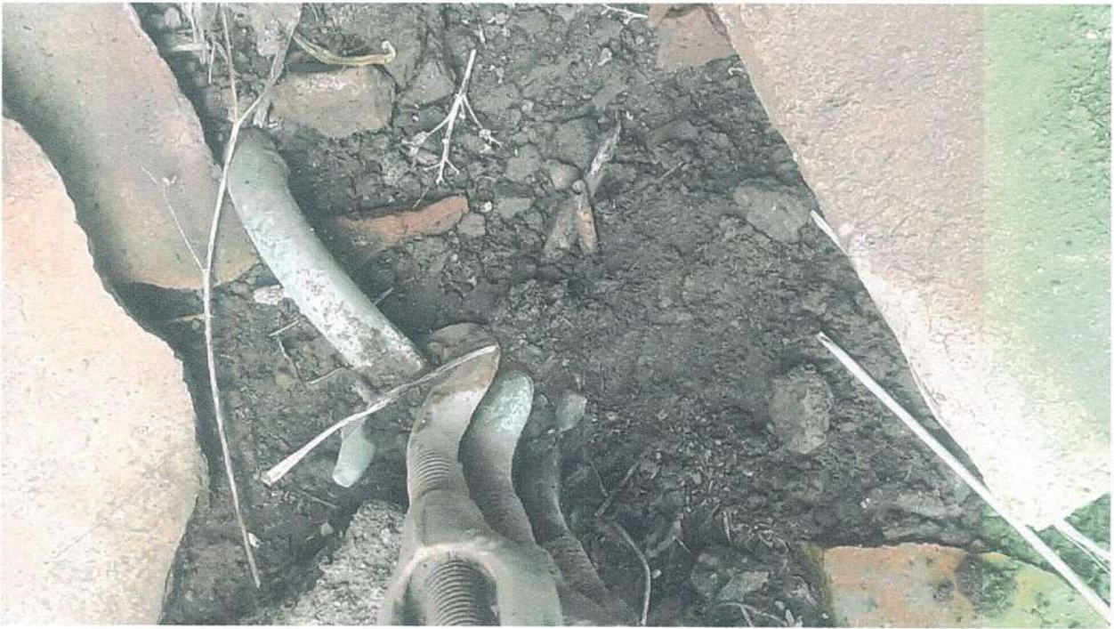
Ilustraciones 4. El sistema de fijación, templadores y el sistema radiante se encuentra en buen estado, sin embargo necesita un mantenimiento preventivo.
