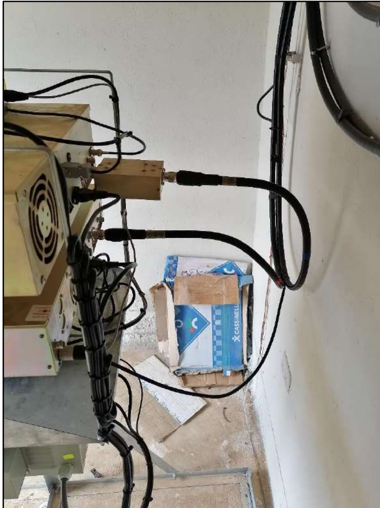
Imagen 12. Cabling de conexión de equipos sin etiquetado.
