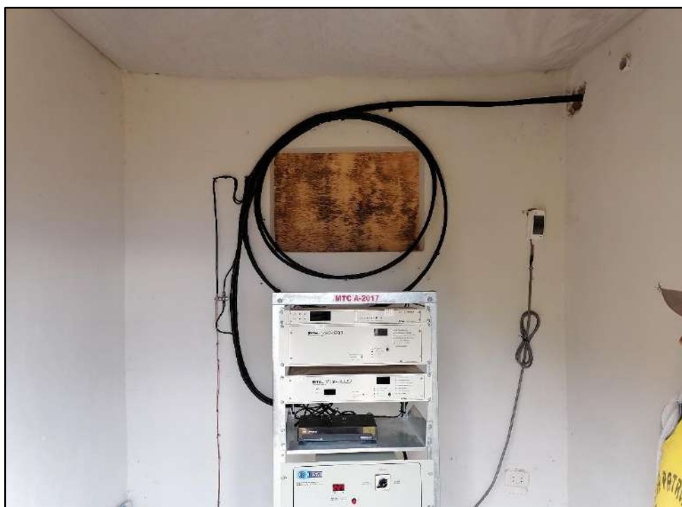
Imagen 10. Llave principal con cableado eléctrico de estabilizador expuestos. Adicional se visualiza huecos por donde ingresan cablería de torre a la caseta.
