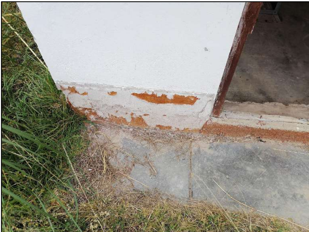
Imagen 16. Zócalo de caseta presenta zonas despintadas y deterioradas.
