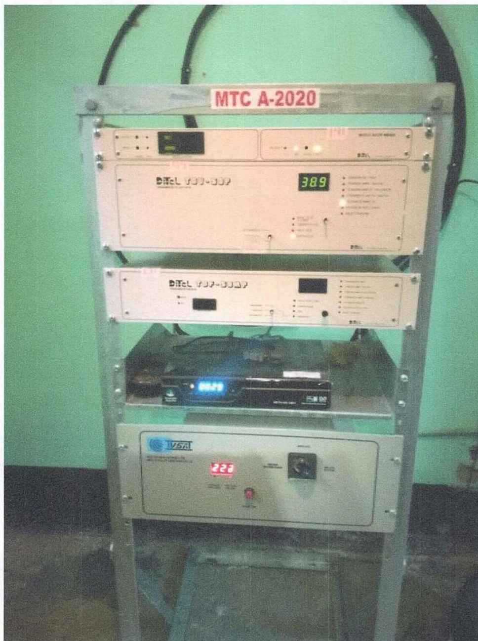
Ilustración 3. Podemos verificar que el transmisor FM necesita Mantenimiento y que el rack de comunicaciones debe tener un mejor aterramiento a los equipos se tendrá que ofertar una tabla de aterramiento independiente para el rack de comunicaciones TBG.
