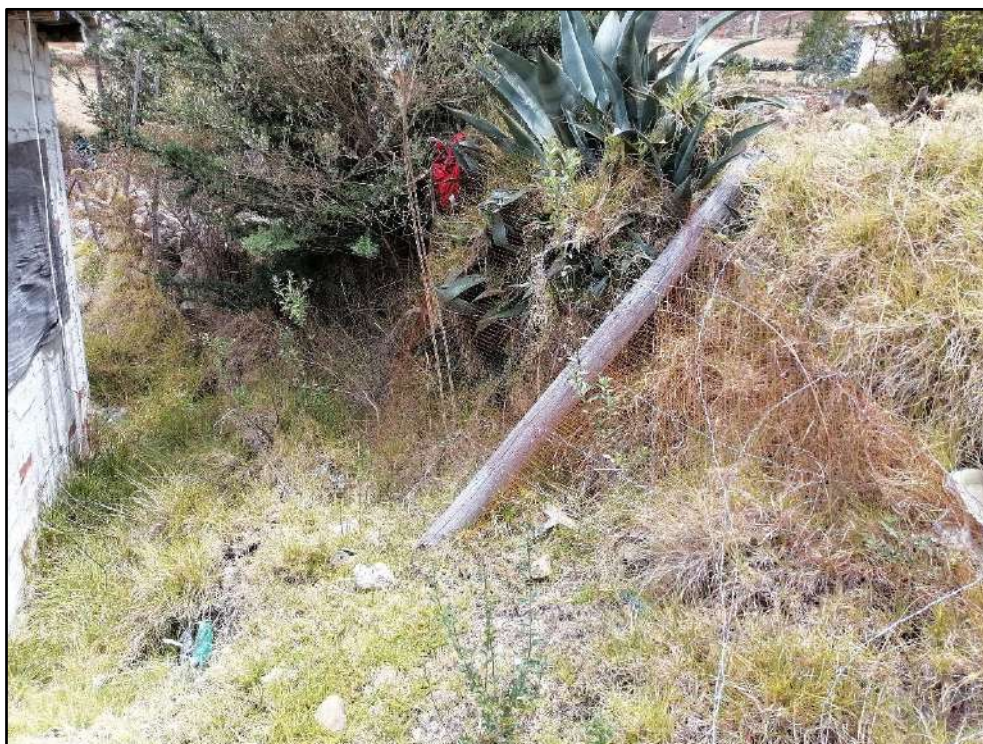
Imagen 4. Poste de madera perteneciente al cerco perimétrico se encuentra tumbado, y necesita reinstalarse.
