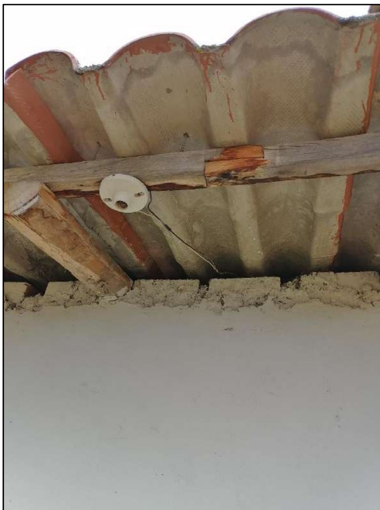
Imagen 19. Techo de caseta con bases de madera y cubierto con ethernit, en mal estado.
