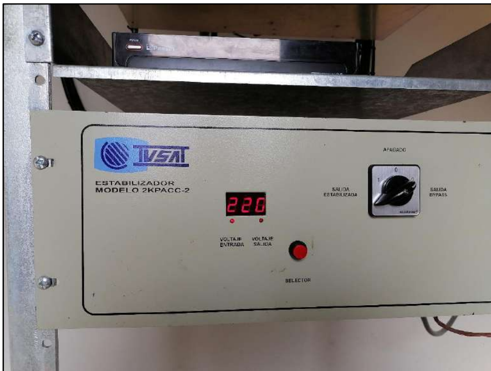
Imagen 14. Voltaje de entrada que recibe la estación CPACC Pacobamba.
