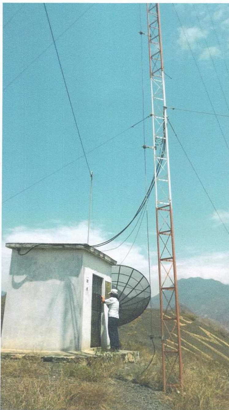
Ilustración 1. Estación de PUNGUCHIQUE necesita mantenimiento preventivo de la caseta de comunicaciones necesita pintura.
