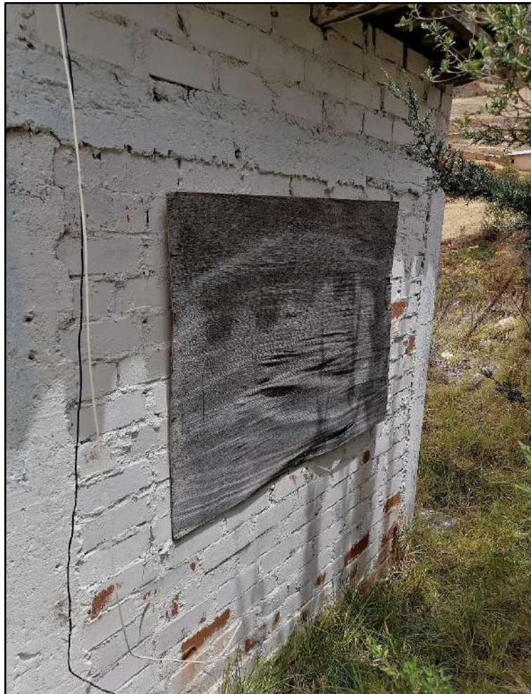
Imagen 6. La caseta no cuenta con ventana de marco metálico, por lo que se requiere suministrar dicho marco.
