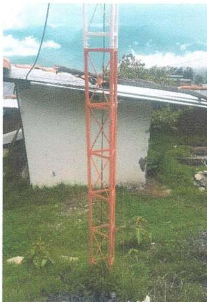
Ilustración 1. Estación de CALIPUY necesita mantenimiento preventivo de la caseta de comunicaciones necesita pintura y resanes.
