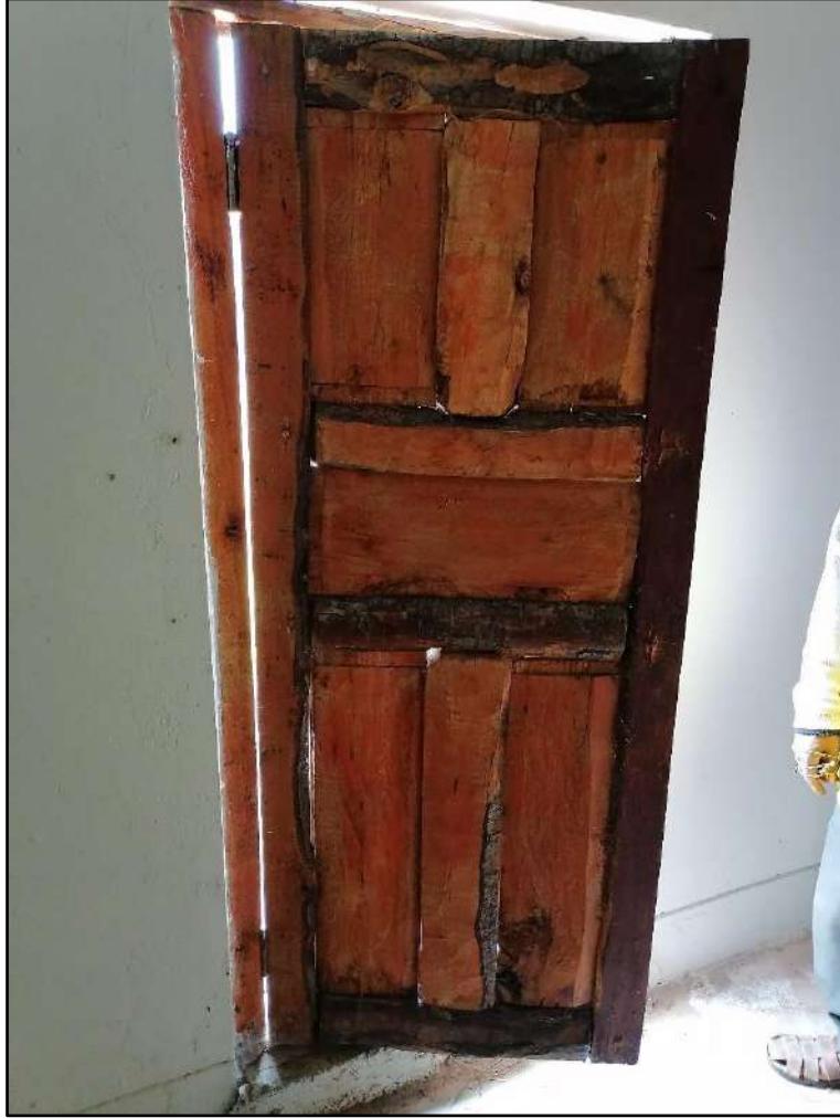
Imagen 15. Puerta de madera de caseta en mal estado.
