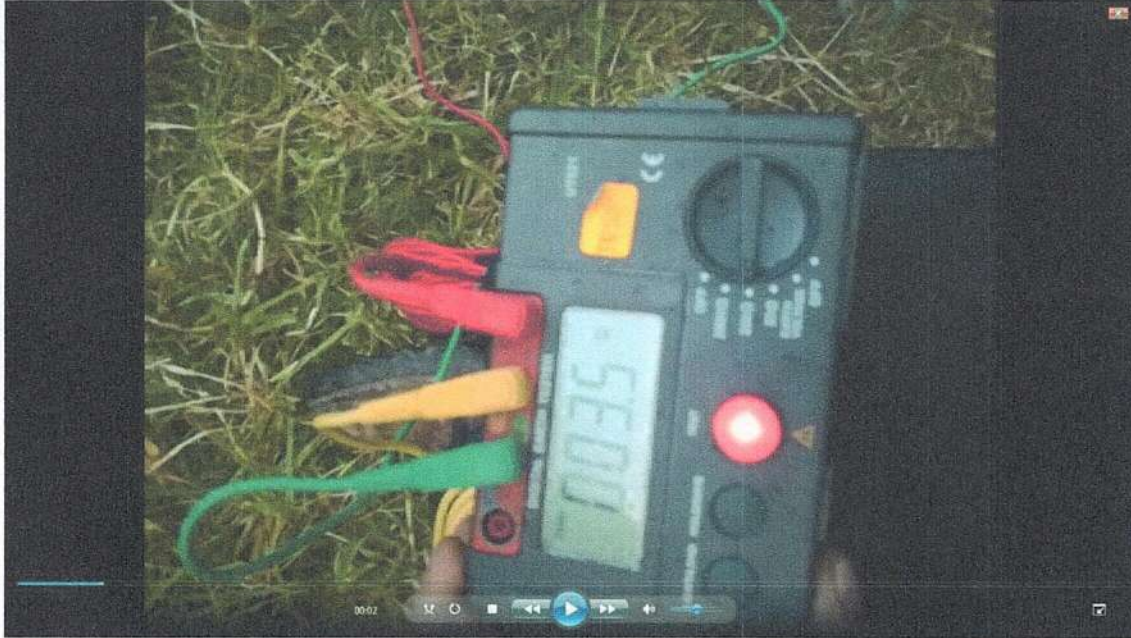
Ilustración 4. Medición de pozo a tierra, la tierra de los equipos esta conectado al pozo a tierra del para rayos, además la caja de registro debe tener conector de cobre entre la varilla de cobre del pozo (en este caso parece haber lamina de cobre) y del cable del para rayos. Se tiene que independizar los sistemas de puesta a tierra.
