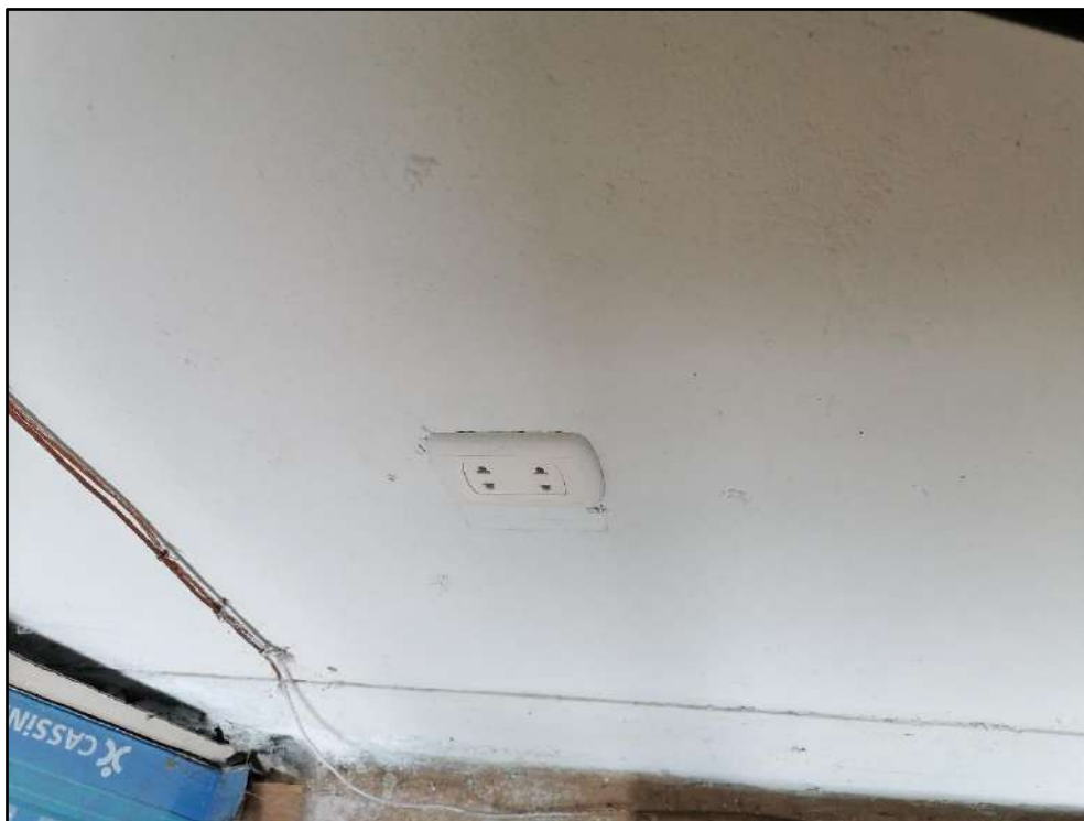
Imagen 18. Tomacorriente de caseta no cuenta con toma a tierra.
