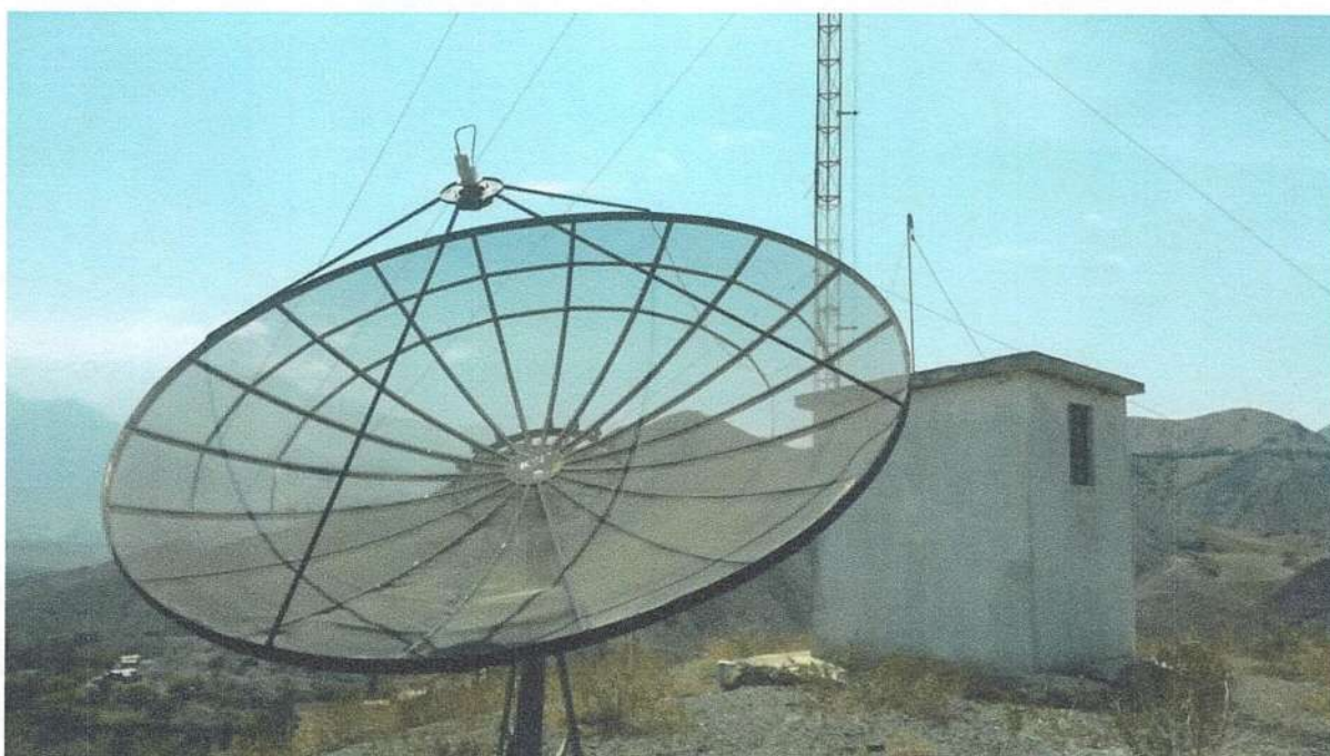
Ilustración 2. Antena Parabólica con necesidad de mantenimiento correctivo.
