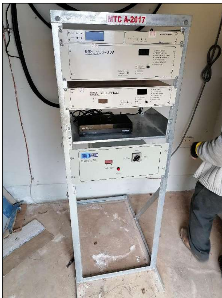
Imagen 9. Transmisor de TV, transmisor FM, Modulador, Receptor Satelital y Estabilizador de tensión de la estación CPACC Pacobamba.
