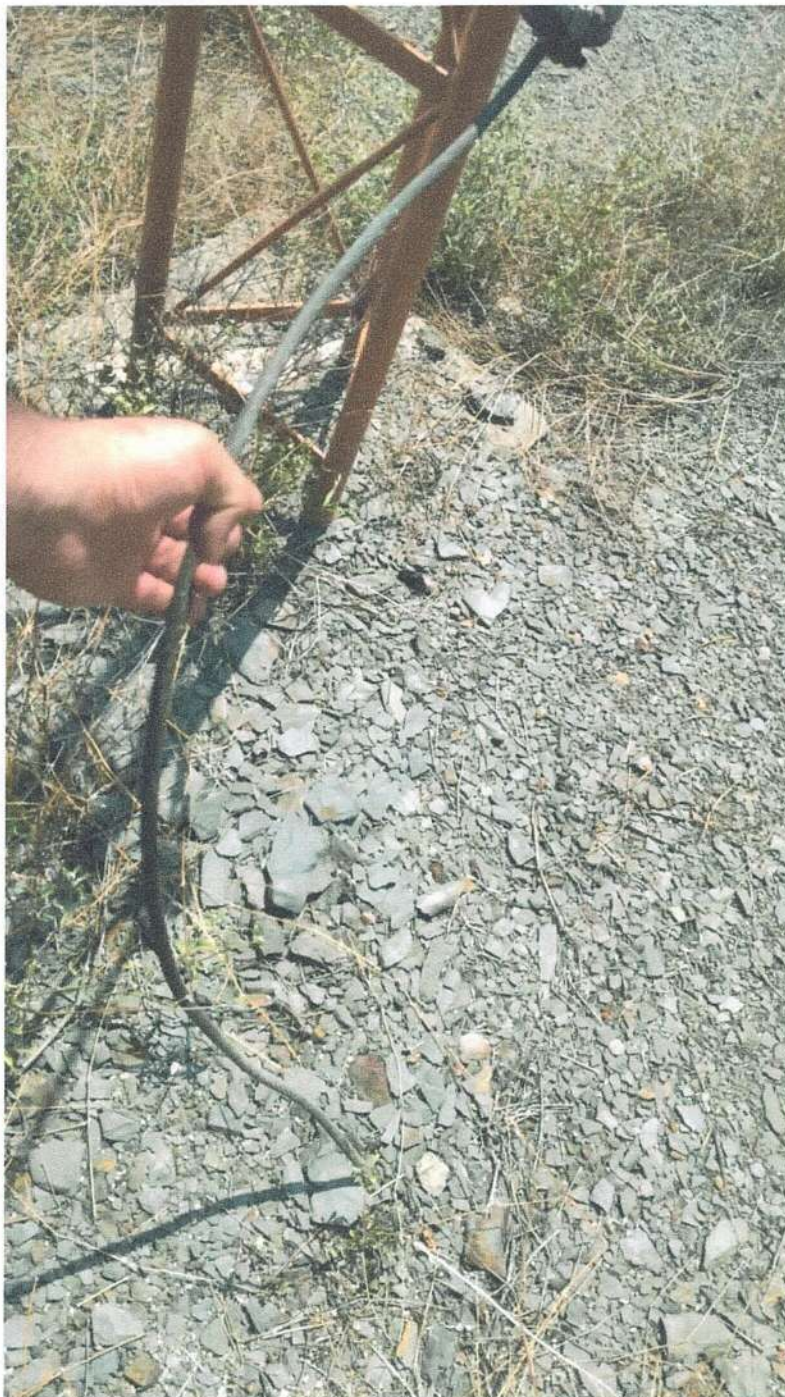
Ilustración 5 Ausencia de caja de registro.
