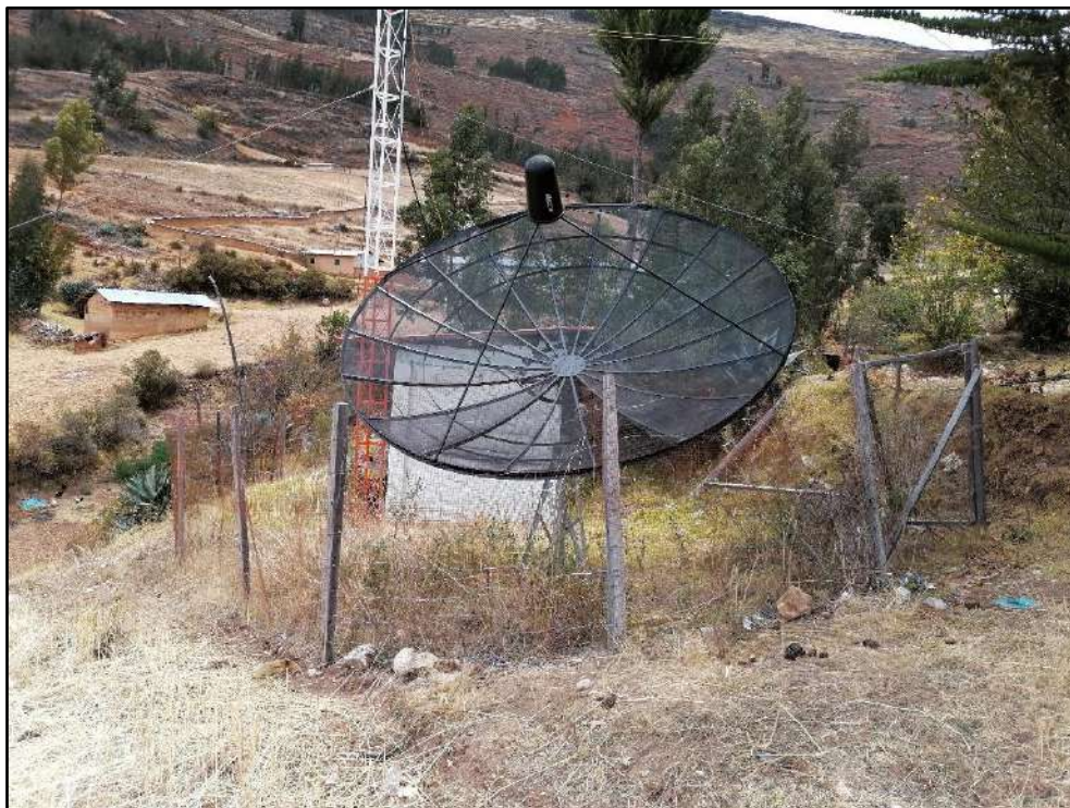
Imagen 3. Cerco perimétrico actual presenta zonas en deterioro y necesita reinstalarse. También se visualiza la presencia de maleza alrededor de la caseta.
